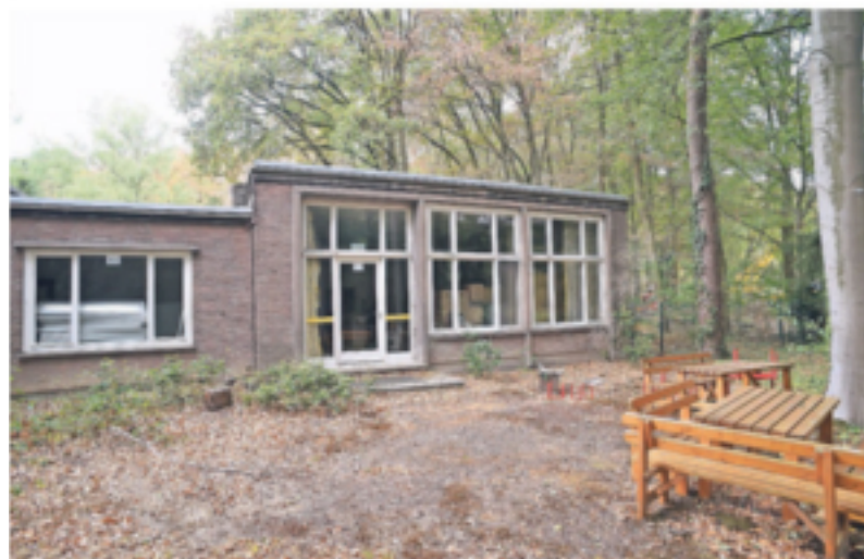
Der gesamte Ostflügel der Schule mit seinen fünf Klassenräumen ist im Bereich der Bewehrung der Betondecke marode.
